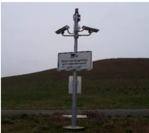
Abb. 4.2: Kamerasystem am Rand des Deponiegeländes
