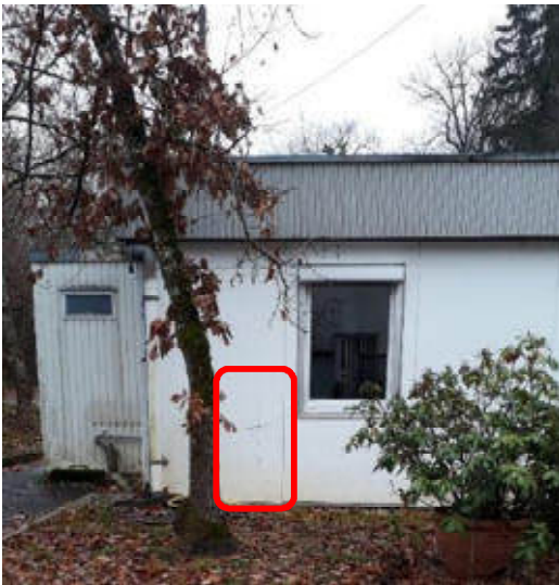
Abb. 18: Riss Außenfassade Betriebsgebäude
