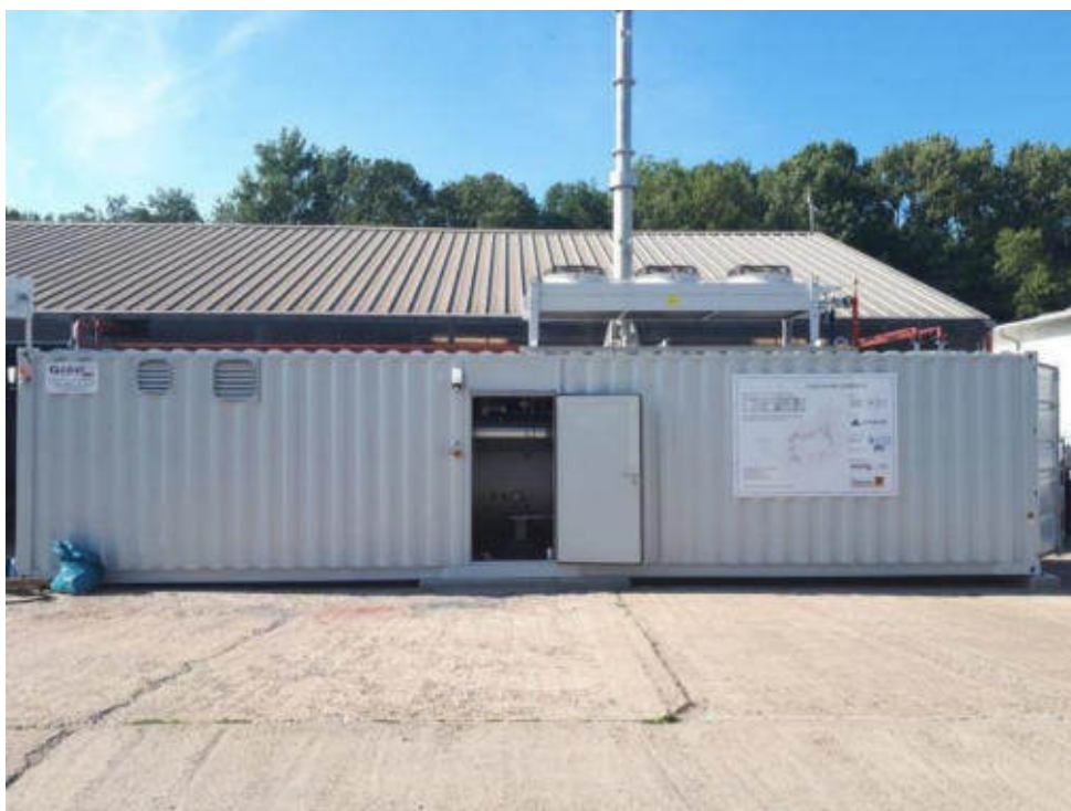
Abb. 14: Ansicht HTX-X Container mit der Verbrennungseinheit
