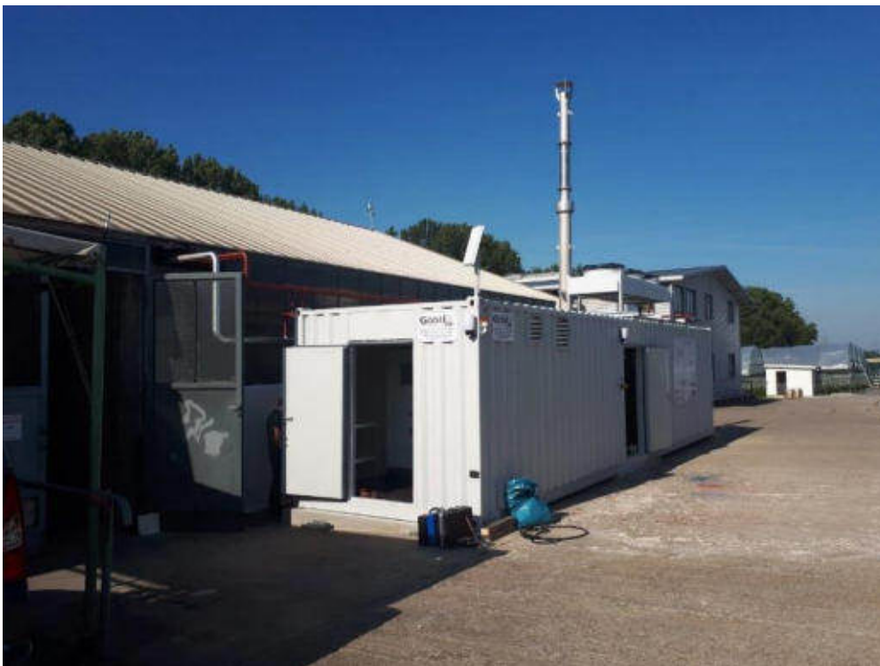
Abb. 13: Schwachgasbehandlungsanlage mit Kontrollraum
