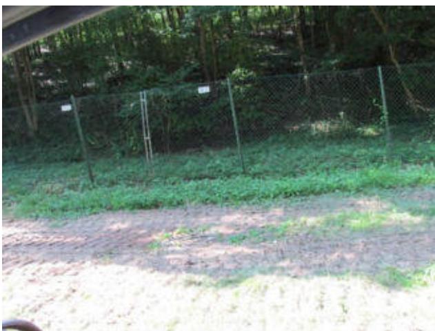
Abb. 3: Ausbesserungen an Schächten Oberflächenwasser
