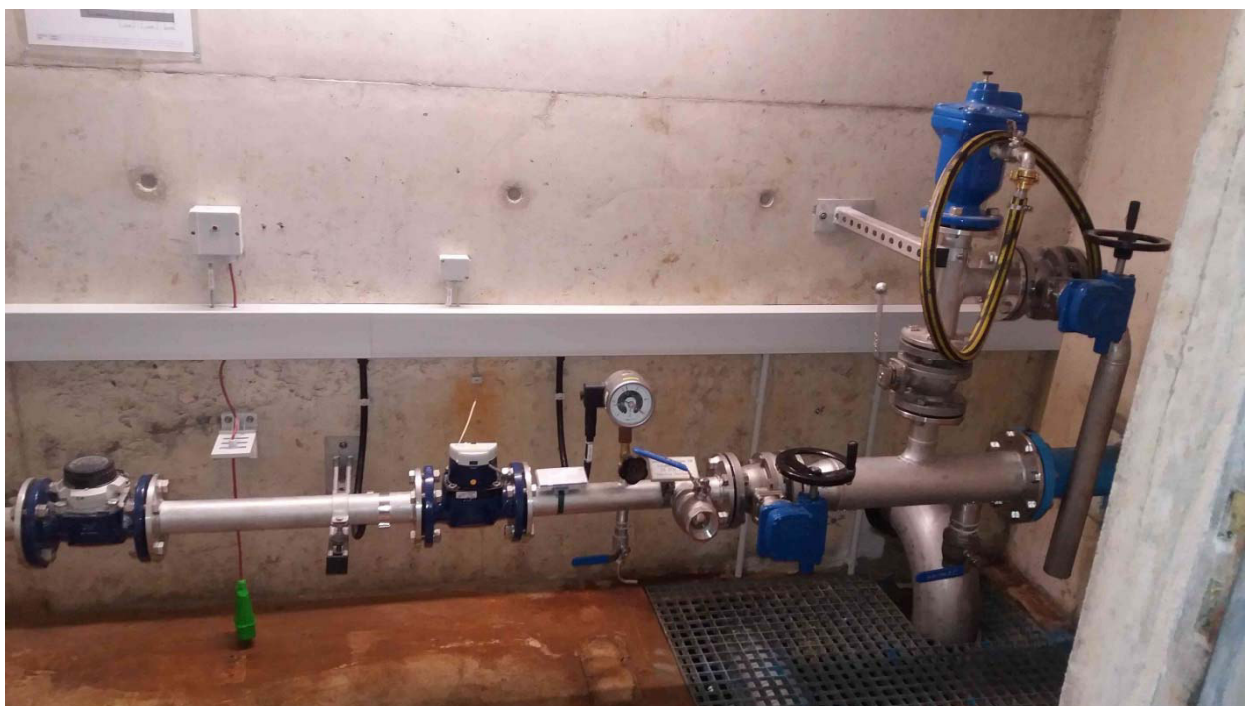
Abb. 4.5: Neue Leitungstechnik im Wasserhochbehälter
