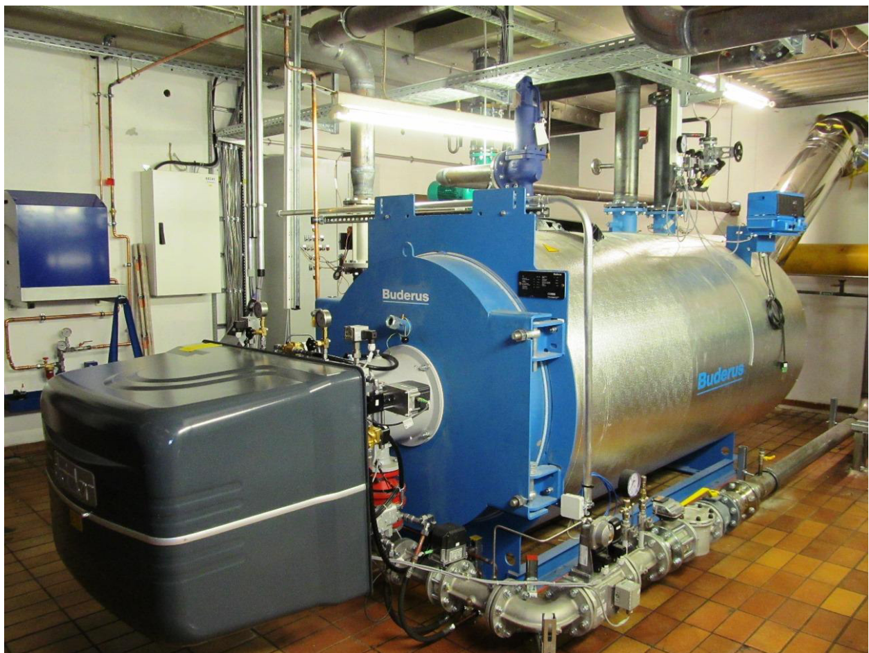
Abb. 4.3: Zweistoffbrenner (Öl/Deponiegas) als Ersatzfeuerung bei Ausfall BHKW oder Zusatzfeuerung zu Spitzenlasten
