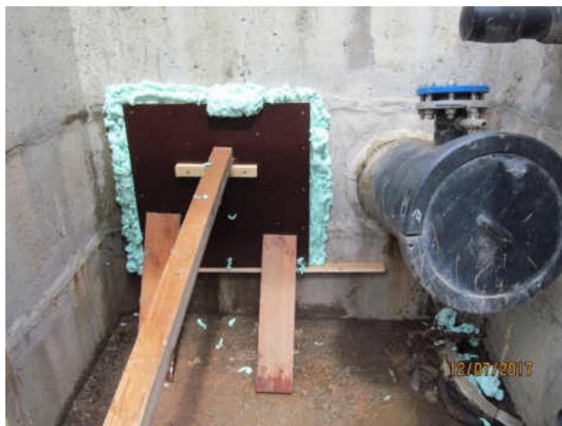
Abb. 4.5: Provisorische Abdeckung des abgebrochenen Spülkopfes vor der Sanierung
