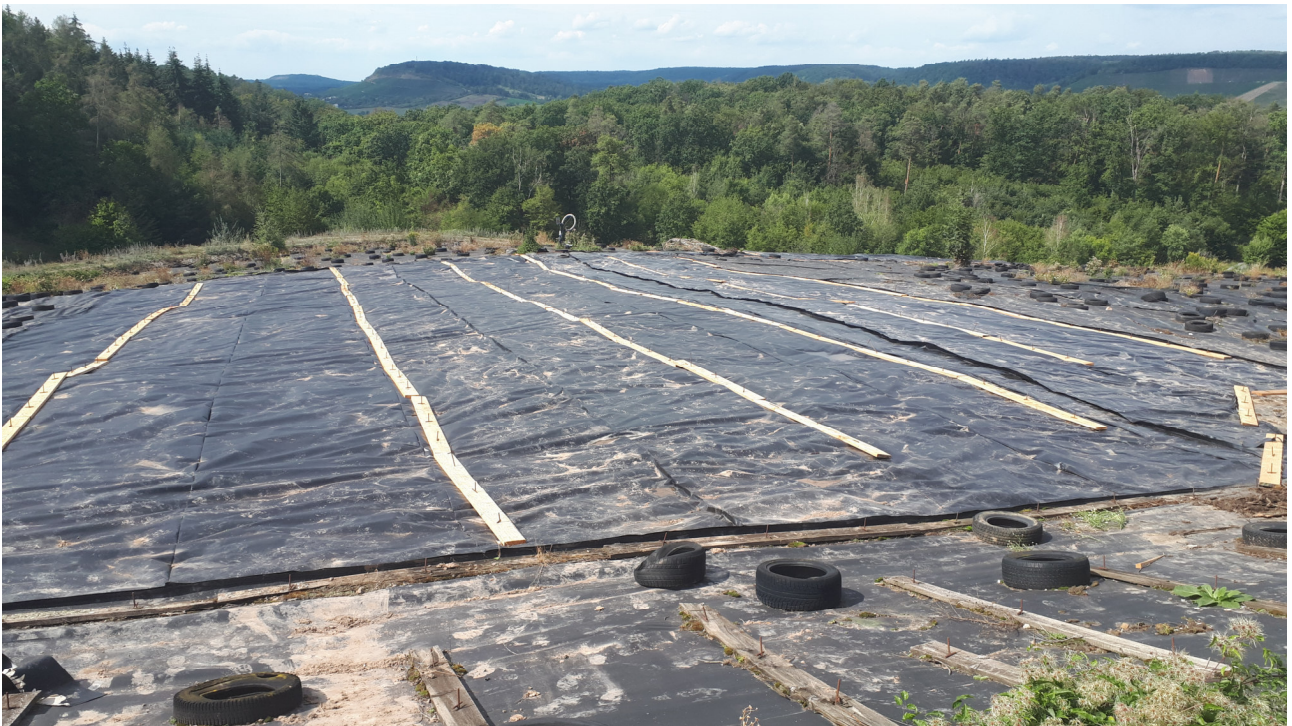
Abb. 4.3: reparierte Schadstelle der temporären Oberflächenabdichtung
